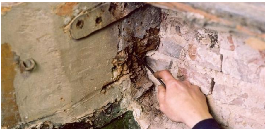
Figuur 73, Er wordt met een priem gekeken tot waar de houtrot zich bevindt
